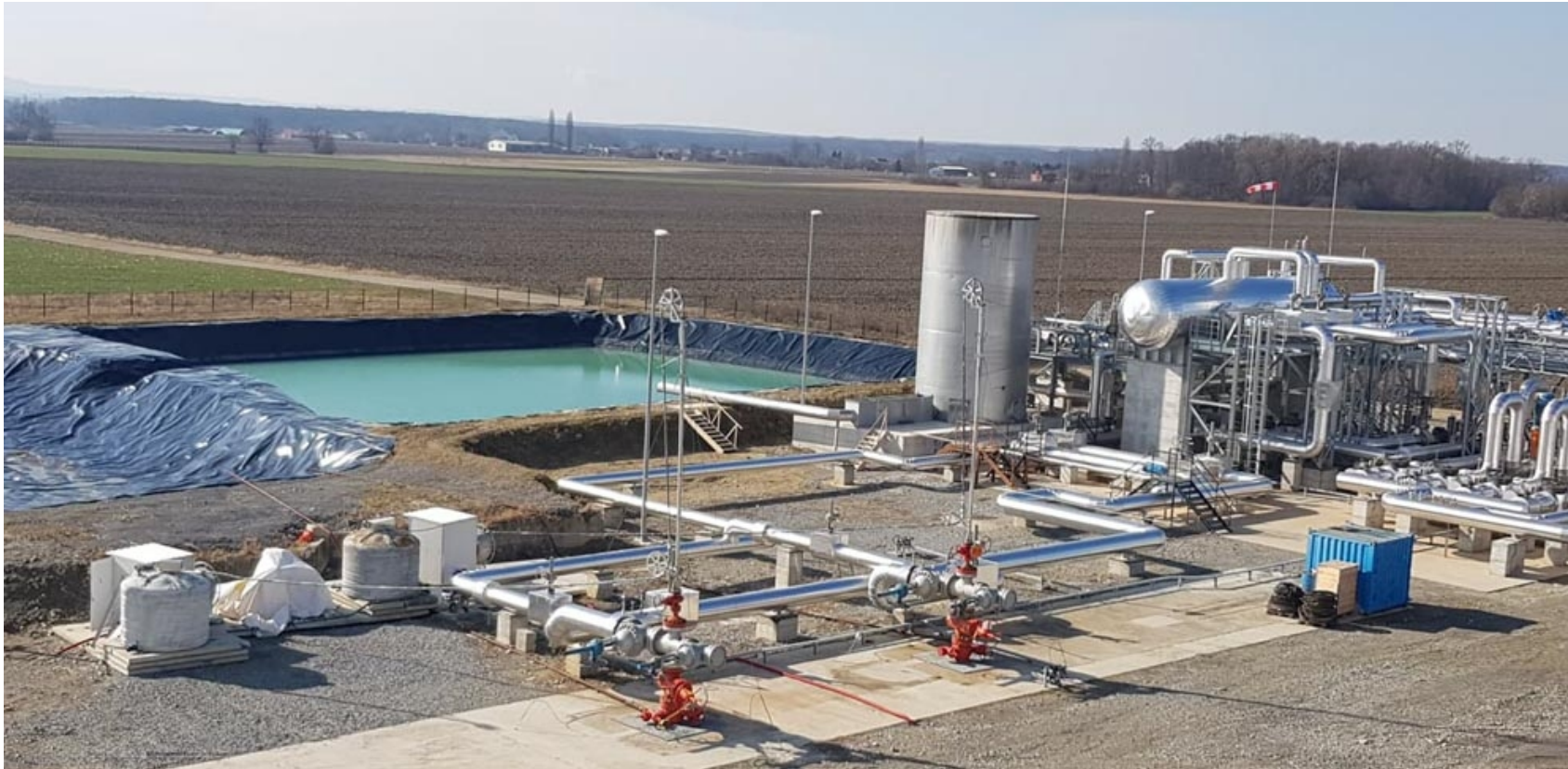
Fotografija 2. Primjer rudarskog dijela postrojenja, lokacija: Geotermalna elektrana Velika 1, Ciglena
