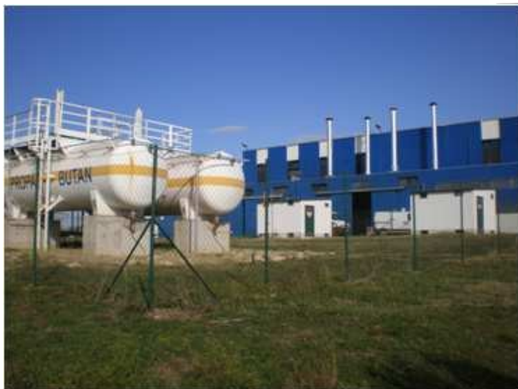
Tvornica tlačnoga lijeva, Benkovac, (instalirana snaga 6 MW - UNP)
